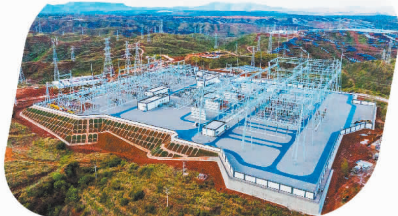
500千伏隆阳变电站
